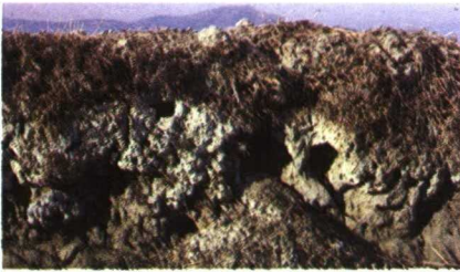
Daños por ratas en acequias
