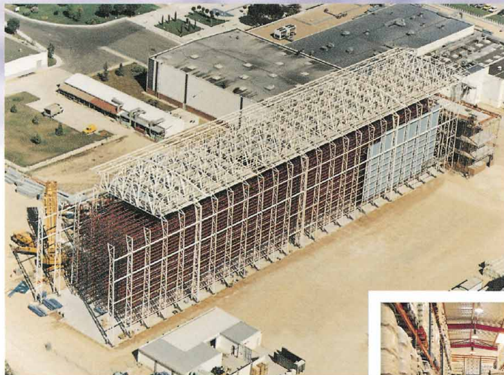
Rack convencional para cargas paletizadas.
