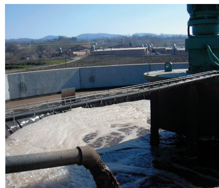
Vista superficial del reactor aerobio de una instalación para la eliminación de nitrógeno situada en Calldetenes (Osona). Foto: A. Magri.
