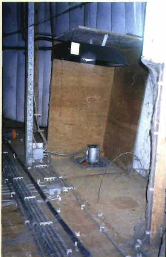
Ventilador impulsor con el radiador de gas como calefactor en invierno.
