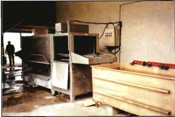
Maquina para lavado de jaulas.
