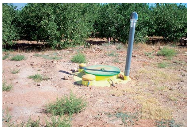
Cuba de hidrolización instalada para su uso
