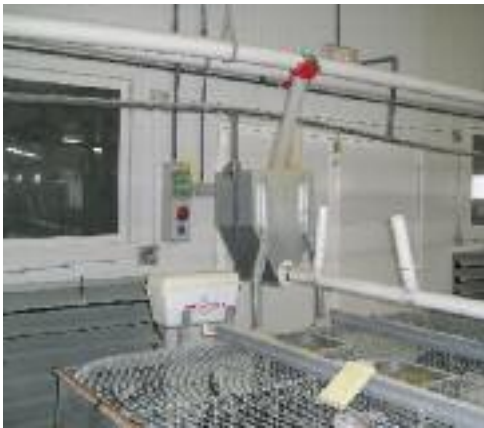
Detalle de la entrada de aire procedente del pasillo de acondicionamiento.
