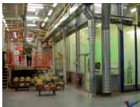
Existen varias cabinas de pintura.
