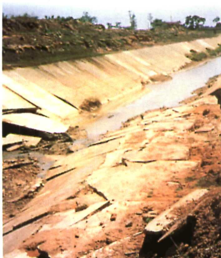
Rotura del revestimiento de un canal.
