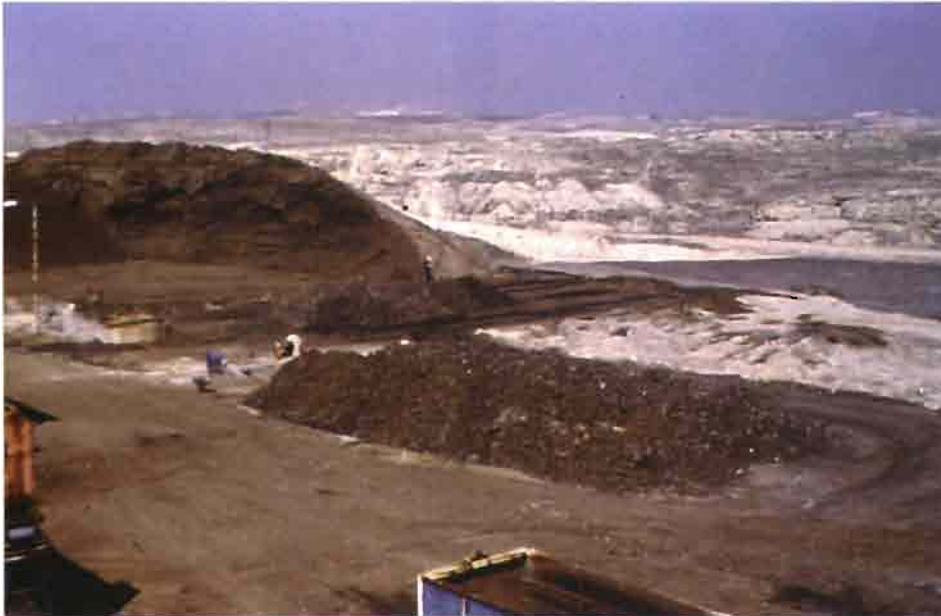
Parque de fermentación de la materia orgánica fresca de las basuras urbanas.
