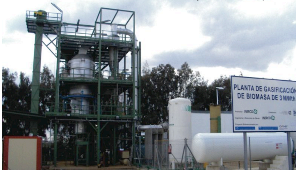
Planta de gasificación. Foto cedida por Inerco
