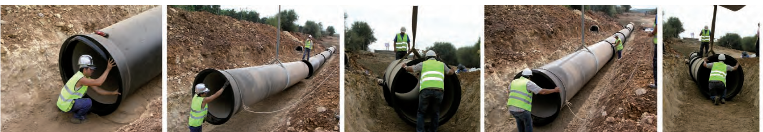
Proceso de montaje: Limpieza, unión entre tubos con junta y alineado, con desplazamiento de hasta 50 cm
