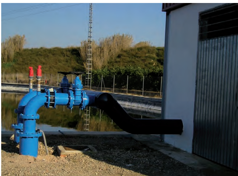
Conducciones de bombas
