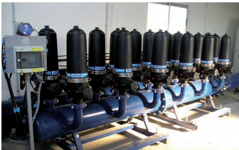
Batería filtros anillas
