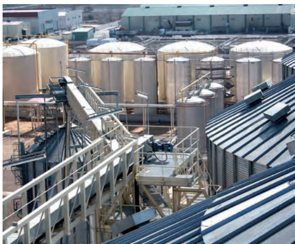
Planta de extracción de biodiésel, a base de colza y girasol, de la cooperativa ACOR en Olmedo
