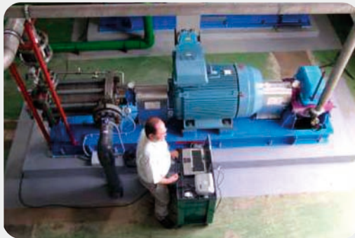
Desaladora del Cangrejo T.M. Valverde, El Hierro, Canarias.
