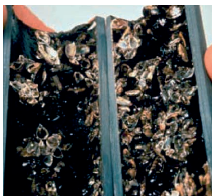
Corte transversal de una tubería taponada por el mejillón cebra. Foto: Schloesser GLSC
