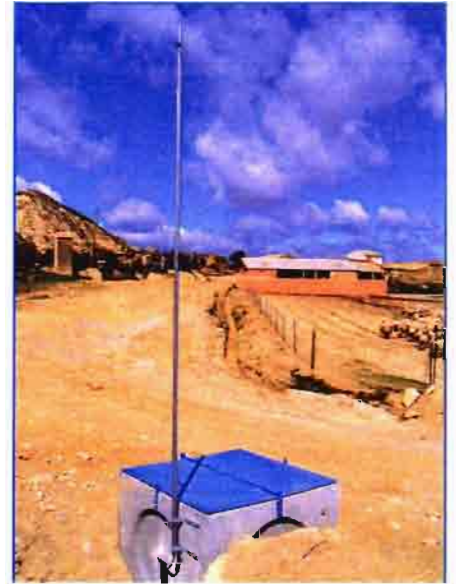
Arqueta tipo con antena radio en Zaragoza
