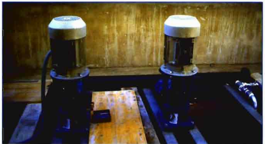
Detalle de grupo de bombeo a la salida de la depuradora
