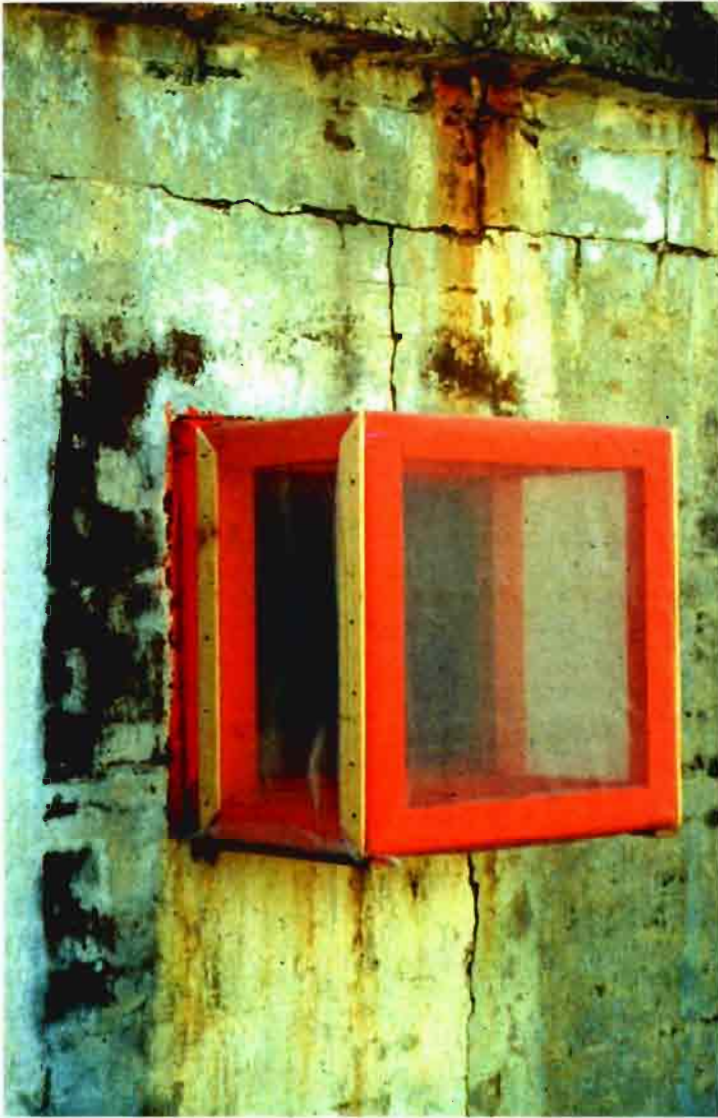
Malla antitrips sobre abertura de ventilación.
