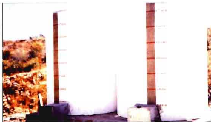
Depósitos de 20 m 3 para las disoluciones 400 veces concentradas en el cabezal de riego. Finca con tratamiento Hydro-UAM.
