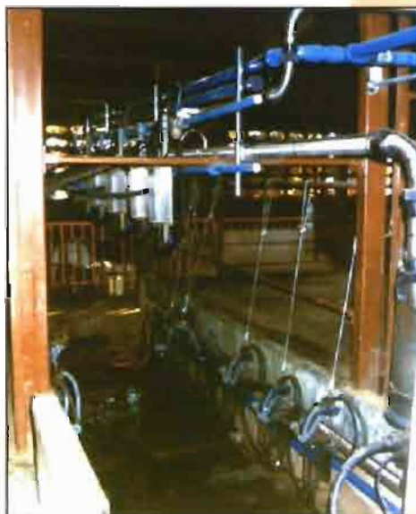
Sala de ordeño de la Universidad Politécnica de Valencia utilizada para la realización de diferentes estudios en ganado ovino sobre la altura de la conducción de leche. Detalle de las 2 conducciones de leche instaladas (línea alta y línea baja).
