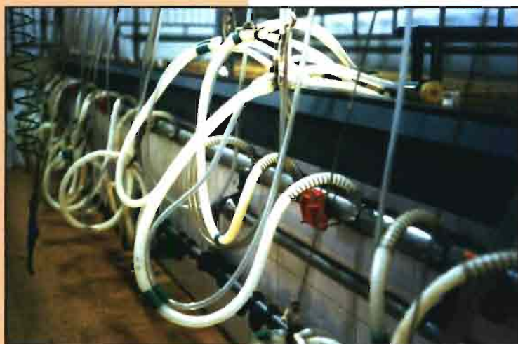
Sala de ordeño tipo Casse con la conducción de leche instalada en línea baja.
