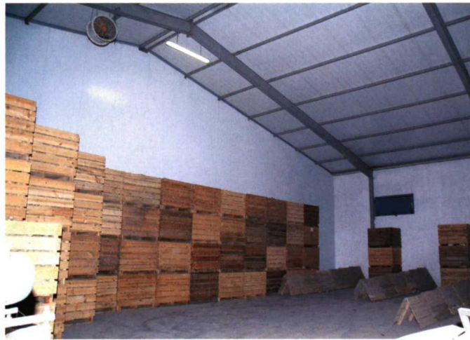
Almacén con ventilación forzada.
