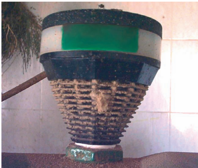
Regulador con falta de limpieza
