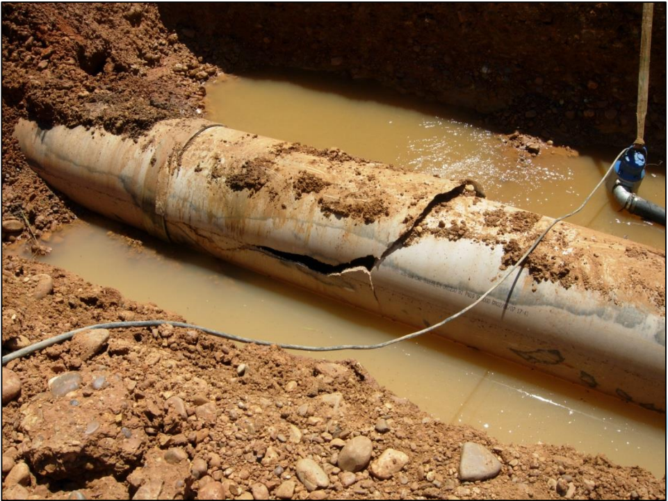
ROTURA FRANCA TUBERÍA DN 1.200 mm
