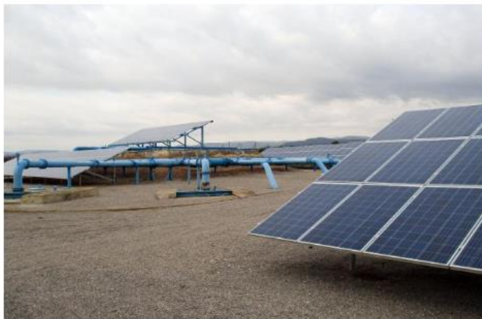
Parte de los 1.160 paneles solares de la Comunidad de Regantes de Liria que alimentan uno de sus pozos. / V. LLADRÓ
