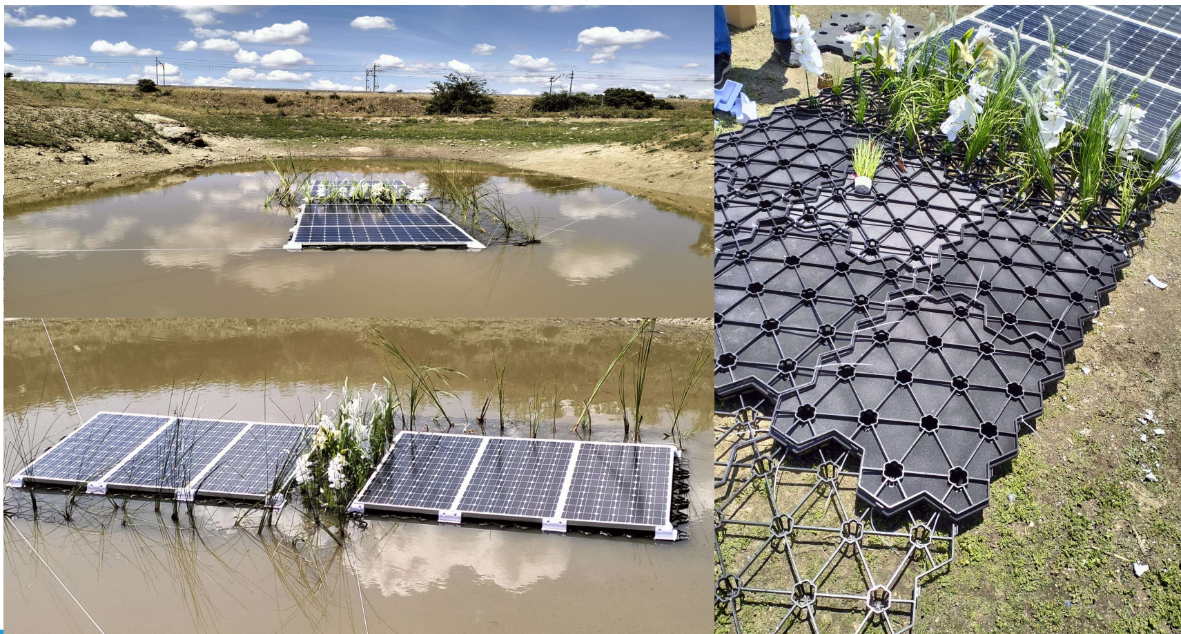
Instalación Fotovoltaica en Finca ganadera (Colmenar Viejo, Madrid)
