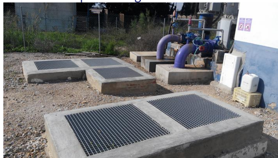
Punto de captación agua EDAR San Javier
