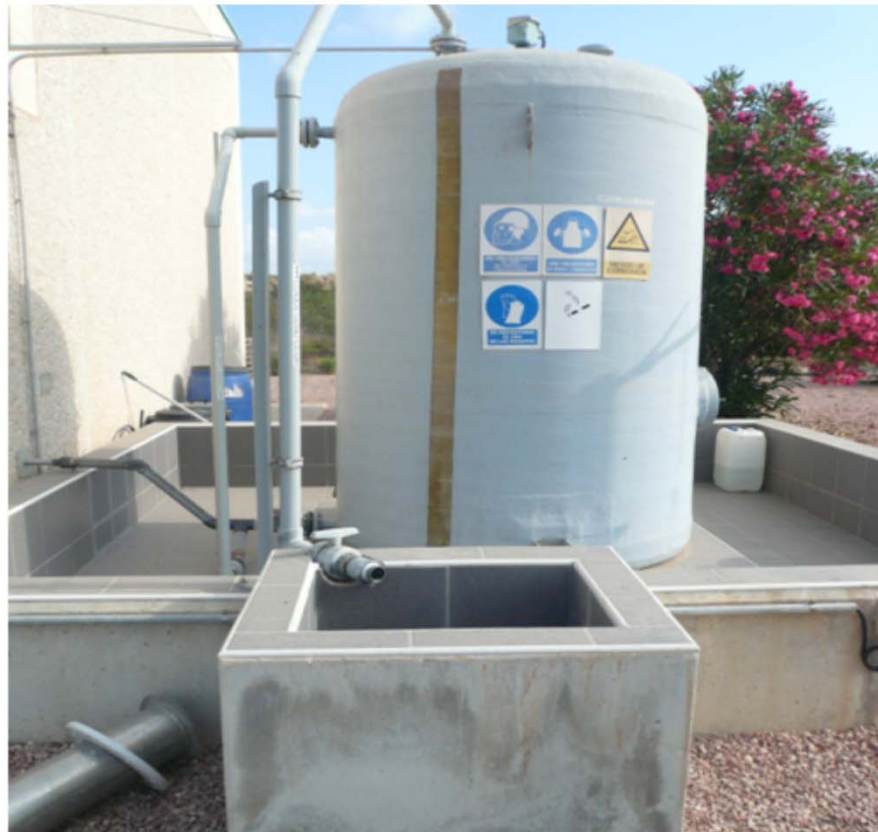
Fotografía N° 3 y 4.- Equipo dosificación y depósito de Hipoclorito Sódico
