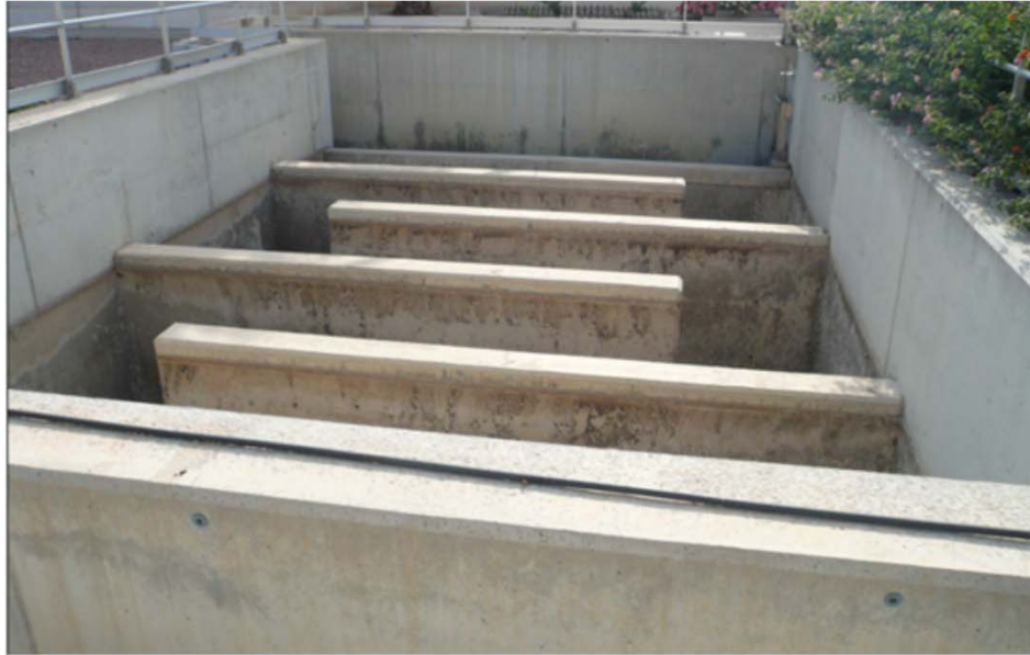
Fotografía N° 5.- Laberinto a la salida del sistema terciario
