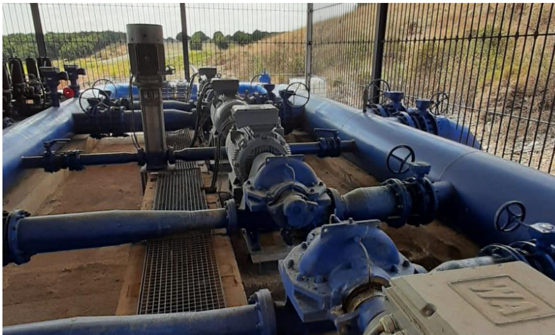
Fotografía n° 2.- Sala de bombas de la Estación de Bombeo Dehesilla 1.
