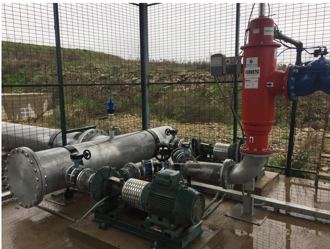
Fotografía nº 3.- Estación de Bombeo Dehesilla 2.
