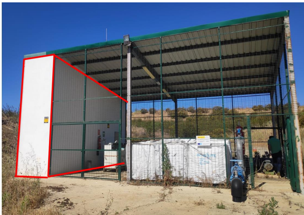
Fotografía Nº 7.- Sala eléctrica E.B. de Dehesilla 2.
