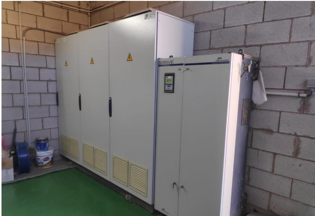
Fotografía nº 6.- Arrancadores a reemplazar por variadores en la E.B. de Dehesilla 1
