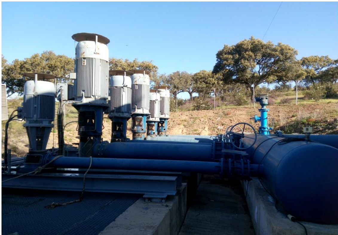
Fotografía nº 1.- Equipos de la Estación de Bombeo Matavacas.
