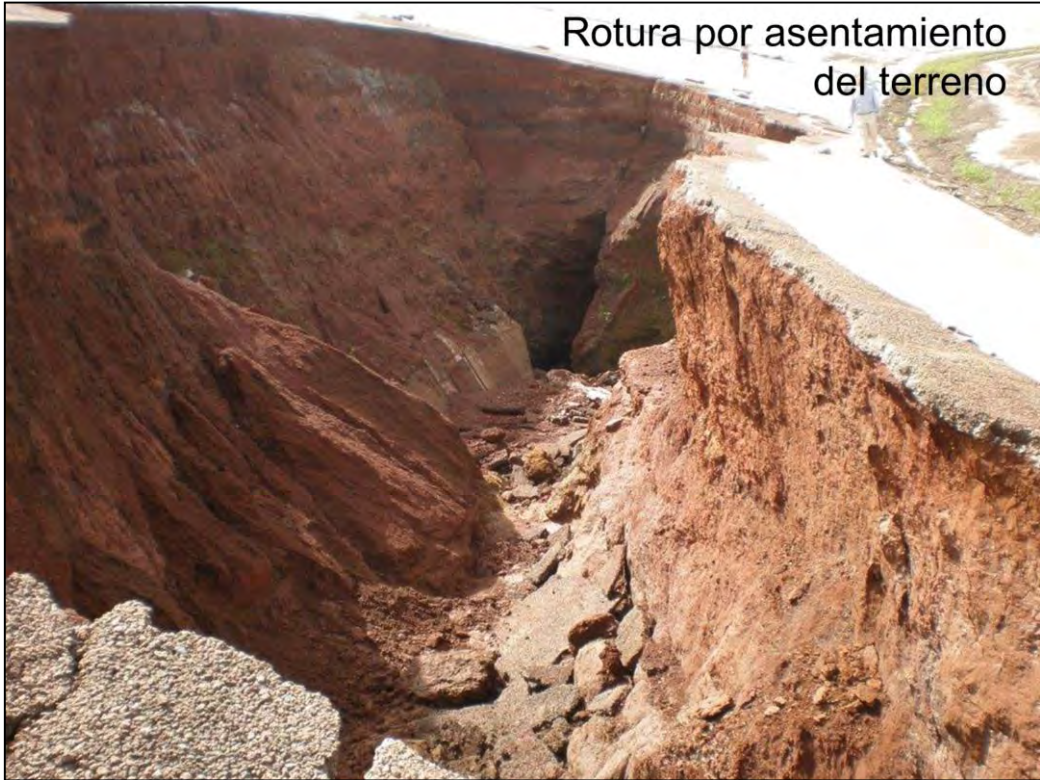
Sifonamiento y asentamiento del dique en la balsa de Barlovento, en las Palmas de Gran Canaria
