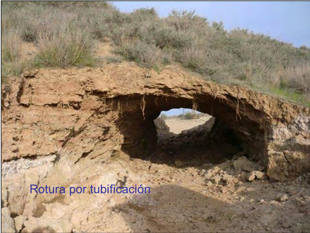
Rotura por tubificación
