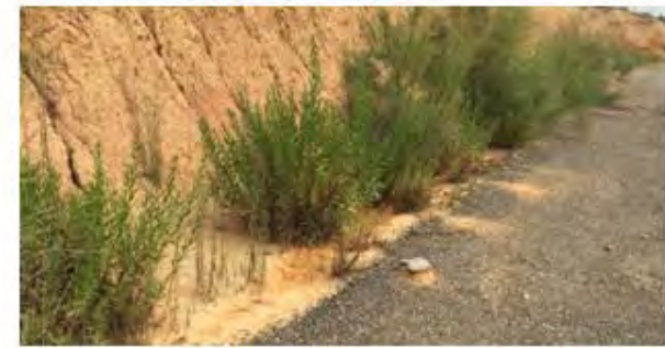
Cuneta Noroeste colmatada al 100%
