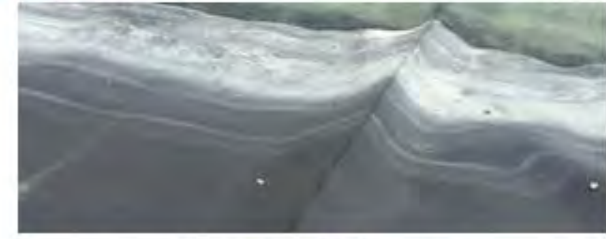
Estado de la lámina de PEAD y soldaduras
