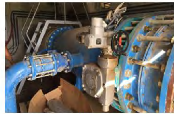
Válvula de corte motorizada de la tubería de explotación y válvula de desagüe
