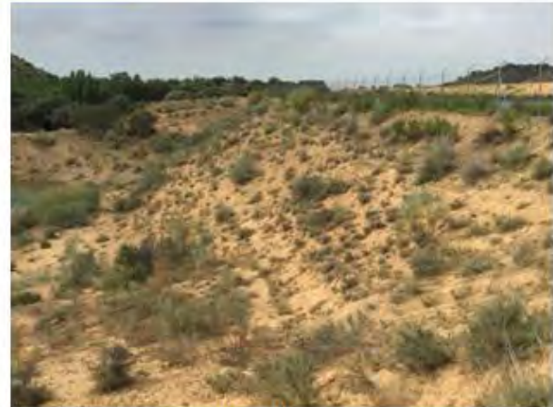
Estado del talud Sureste
