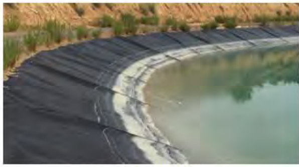
Estado de la lámina de PEAD y soldaduras
