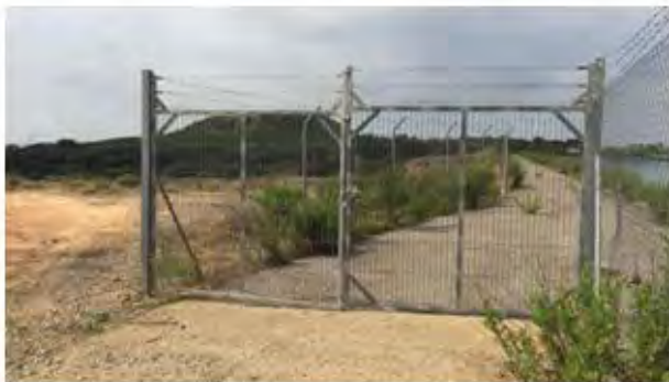
Estado puerta acceso
