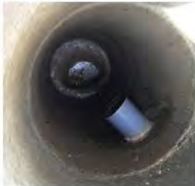
Interior pozo de registro de drenajes y desagüe del filtro
