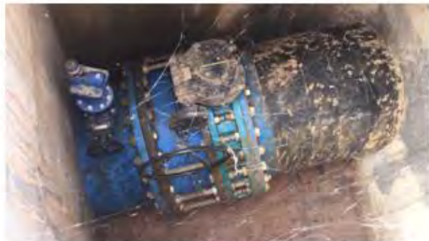
Estado interior arqueta de la válvula de corte de la tubería entrada con nueva ventosa
