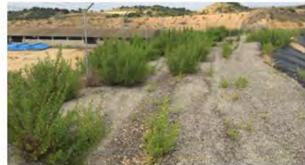
Camino de coronación. Zona con deformaciones en el piso
