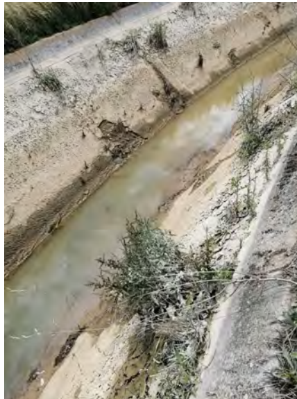
Imagen 6.- Situación actual del Canal de San José en Villalazán (Aprox. Km 37+500). Esta fotografía se ha realizado el 21/06/2021 en plena campaña de riego, durante una de las paradas que realizan de forma obligatoria semanalmente. Se puede observar las roturas en los paños del canal, la presencia de vegetación en los taludes y la fisura continua en la unión entre el Canal y el recrecido del mismo que hubo que realizar para que el agua llegase al Sector I de la Zona regable (Zamora y Villaralbo).
