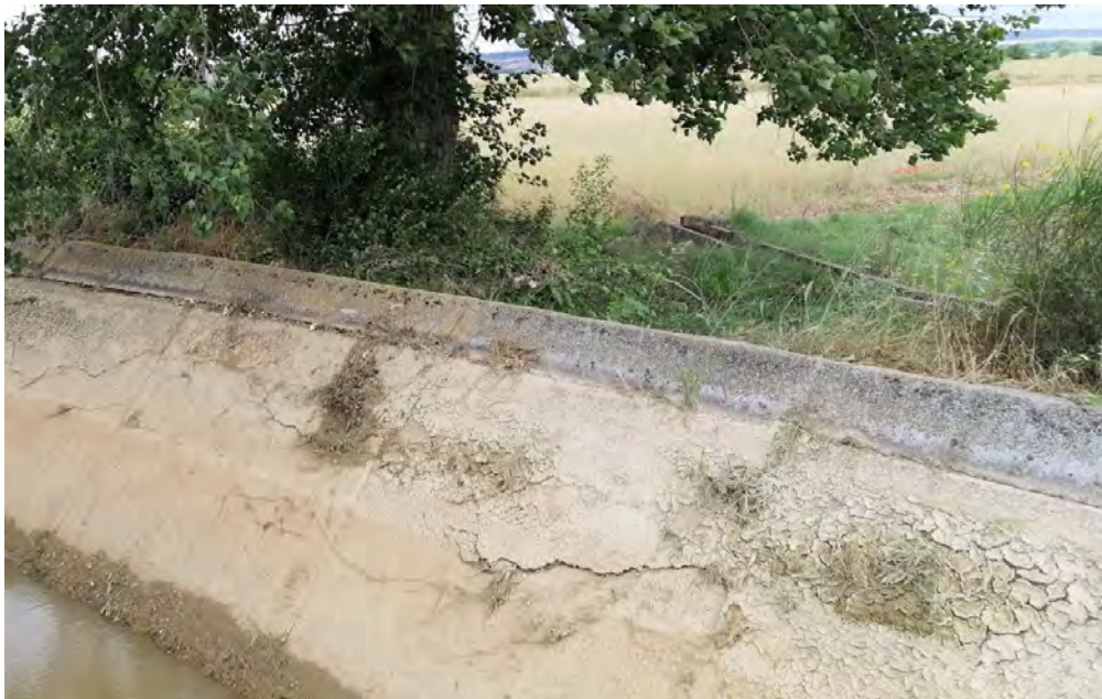
Imagen 4.- Situación actual del Canal de San José en Villalazan (Aprox. Km 37+100). Presenta numerosas grietas en el talud y una fisura longitudinal continua en todo este tramo en la unión entre el canal y un recrecido que se realizó posteriormente para poder garantizar un mínimo de riego en el Sector I del Canal de San José (Zamora-Villaralbo), aun así, actualmente no les llega suficiente agua para garantizar el riego durante la campaña.
