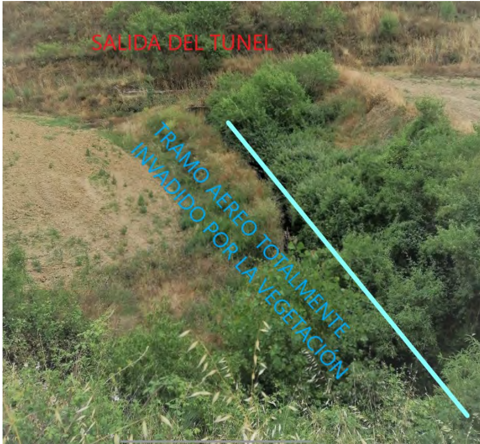
Imagen 7.- Situación actual del Canal de San José en la zona del Yacimiento Arqueológico “El Alba”, declarado B.I.C. Tramo aéreo del canal en una zona totalmente invadida por la vegetación y sin camino de acceso para mantenimiento.
