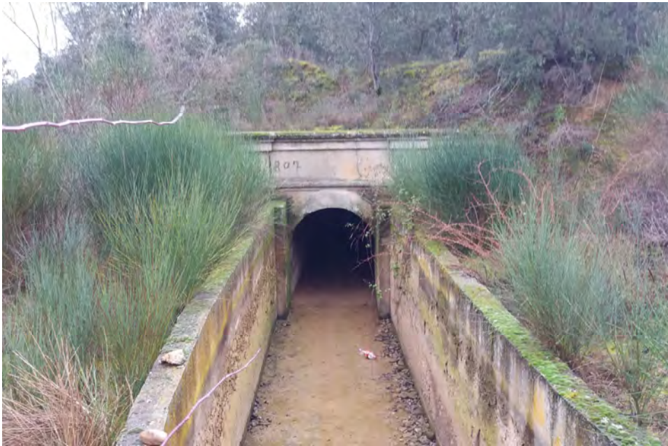
Imagen 2.- Situación actual del Canal de San José en la zona de la Granja Florencia (entre el Km 32 y km 33 con un tramo de túneles). En una zona totalmente invadida por la vegetación y sin camino de acceso para mantenimiento.
