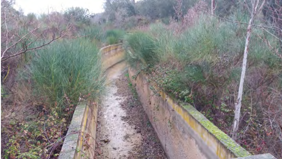
Imagen 1.- Situación actual del Canal de San José en la zona de la Granja Florencia (Km 32+000). Zona totalmente invadida por la vegetación y sin camino de acceso para mantenimiento. Este tramo aéreo tiene una longitud aproximada de 630 m hasta el siguiente túnel.
