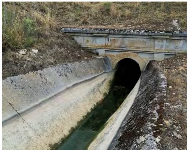
Imagen 8.- Salida de un tunel de longitud 1.780 m del Canal de San José en la zona de Valcuevo. Entre Villalazán y Villaralbo.
