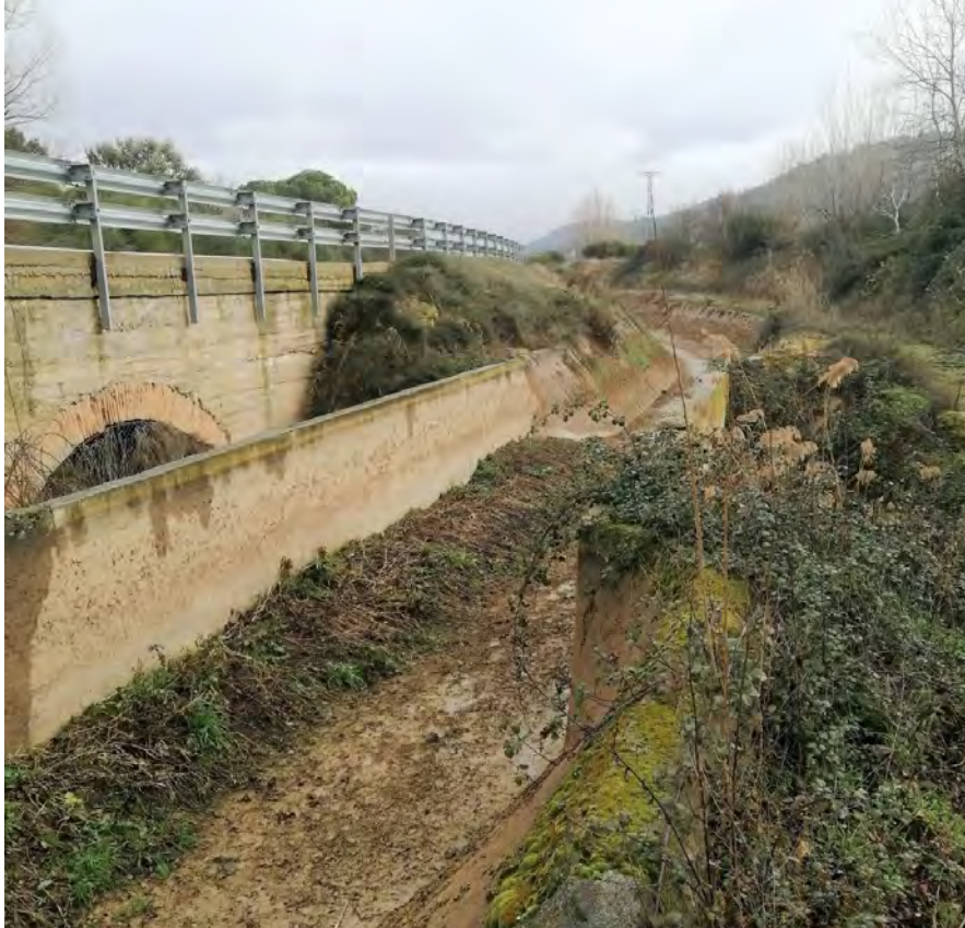
Imagen 3.- Situación actual del Canal de San José en una zona en la que discurre paralelo a la carretera ZA-P-1102 (Aprox. Km 33+200). Se puede observar la gran cantidad de materiales depositados por arrastres a lo largo del Canal. Dichos arrastres dificultarían enormemente el riego modernizado en el caso de mantener el Canal.
