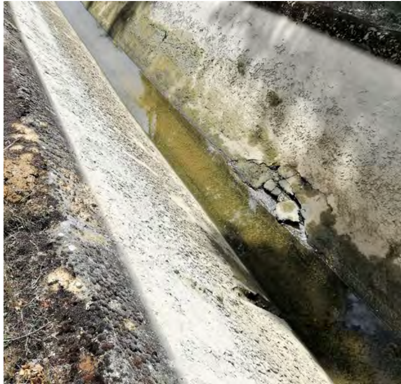
Imagen 9.- Estado del Canal de San José en la zona de Villaralbo. Pk 41+200 aprox.
