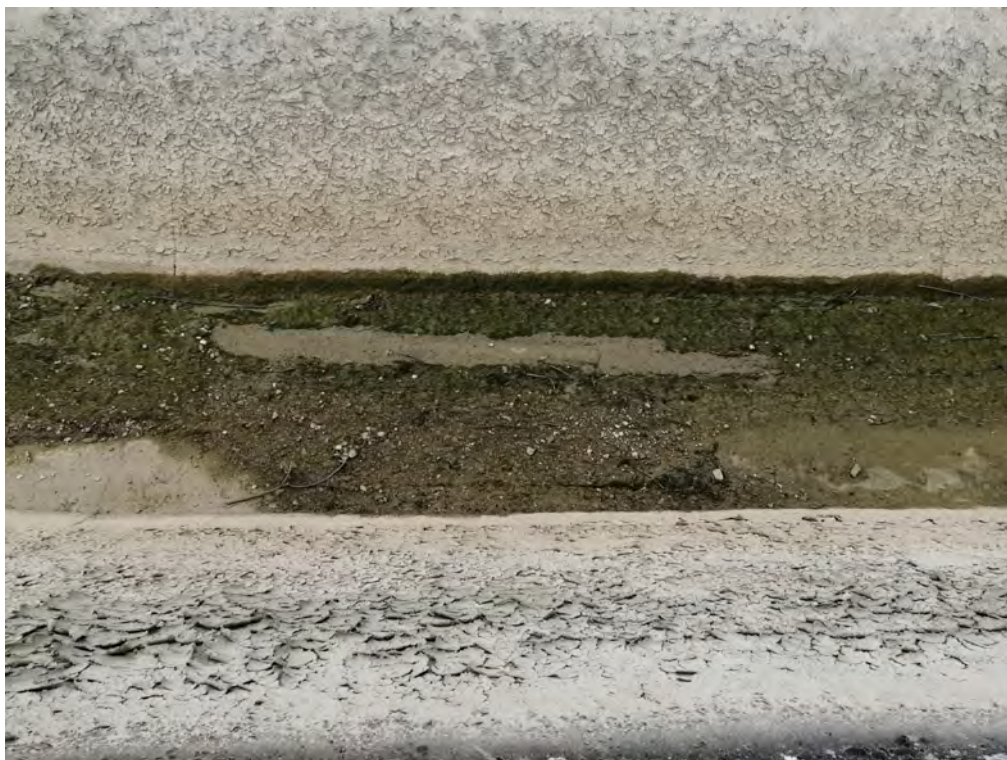
Imagen 11.- Estado del Canal de San José en la zona de Villaralbo. Pk 43+500 aprox. Se pueden observar los depósitos de piedras y tierra en el fondo y el limo adherido a los taludes del Canal. Fotografía tomada el 21/06/2021 en plena campaña de riego en una de las paradas semanales obligatorias.
