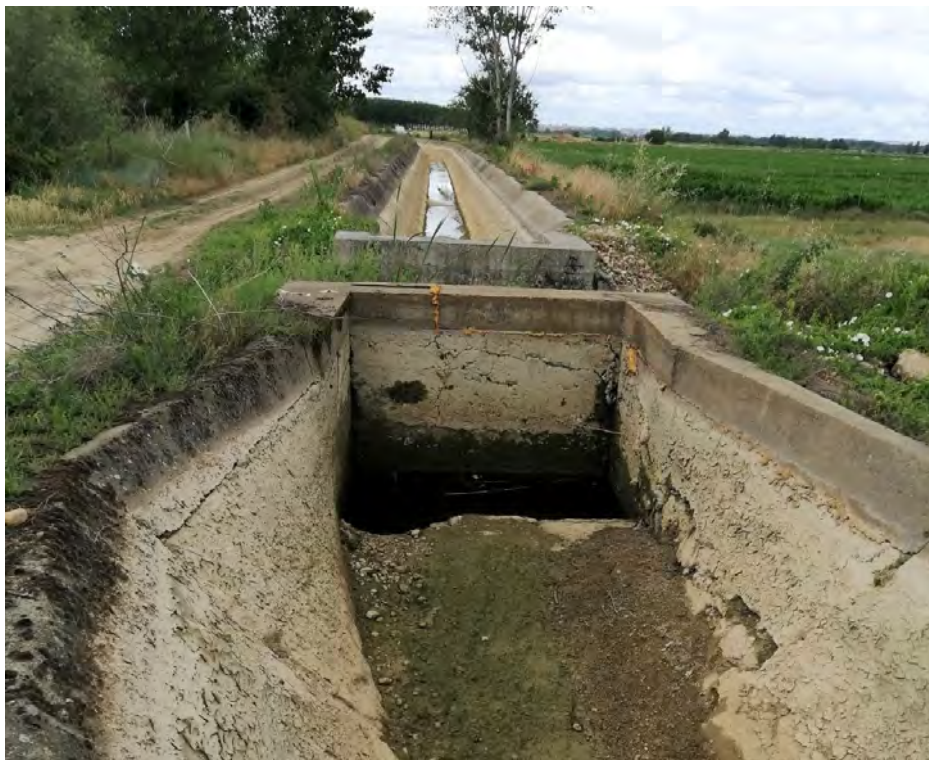
Imagen 10.- Estado del Canal de San José en la zona de Villaralbo. Pk 41+500 aprox. Se observan las fisuras en el hormigón y los depósitos de piedras y tierra en el fondo. Fotografía tomada el 21/06/2021 en plena campaña de riego en una de las paradas semanales obligatorias.
