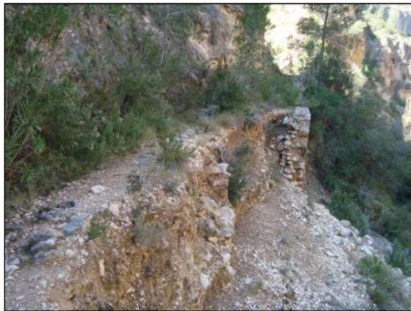
Detalle de muro derrumbado. Tramo a arreglar.
