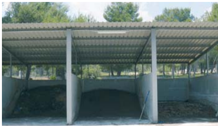
Figura 2. Almacenamiento de deyecciones sólidas en estercolero.
