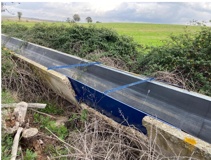
Ilustración 15.- Estado actual de paños de acequia prefabricada en la acequia A-XXXV-J.
