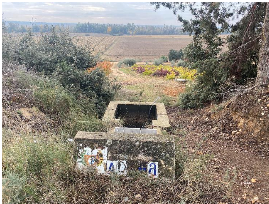
Ilustración 6.- Punto de toma de acequia A-X-a en Canal secundario nº2.
