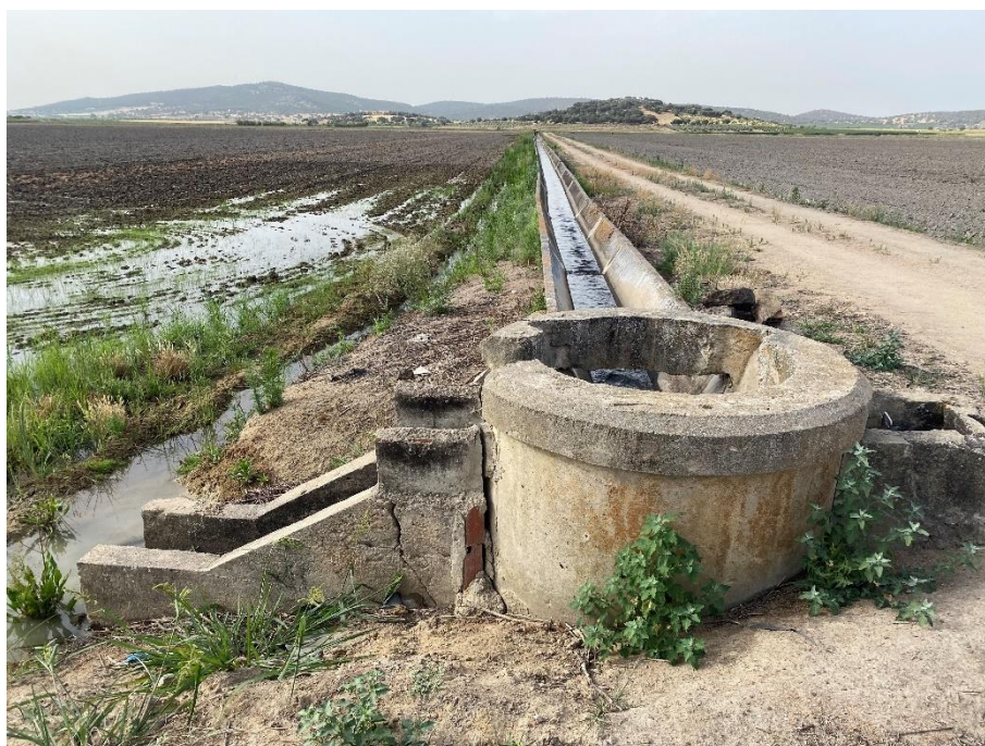
Ilustración 10.- Filtraciones en acequia A-XX-A-15-4.
