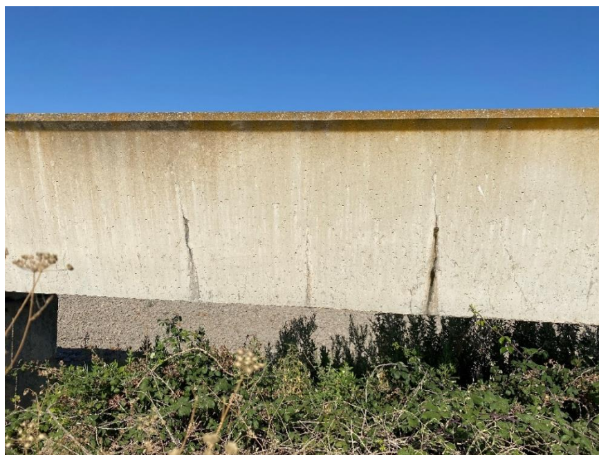
Ilustración 14.- Fisuración en paños de acequias
