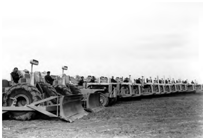
Cuadrillas de trabajadores con maquinaria pesada preparadas para los trabajos de nivelación del terreno.
