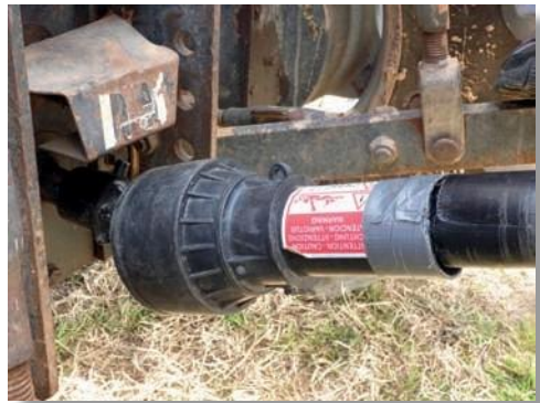
No existe la cadena de sujeción en el árbol de la máquina
