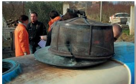
Filtro de llenado en condiciones no aceptables
