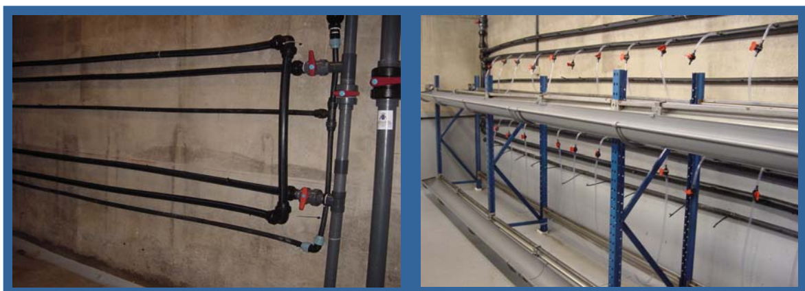
Figura 36. Fases de la nueva instalación. Red de agua fría, caliente, aireación y sistema de desagüe
