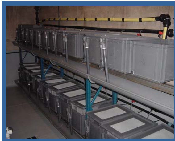
Figura 37. Vista general de la nueva instalación
