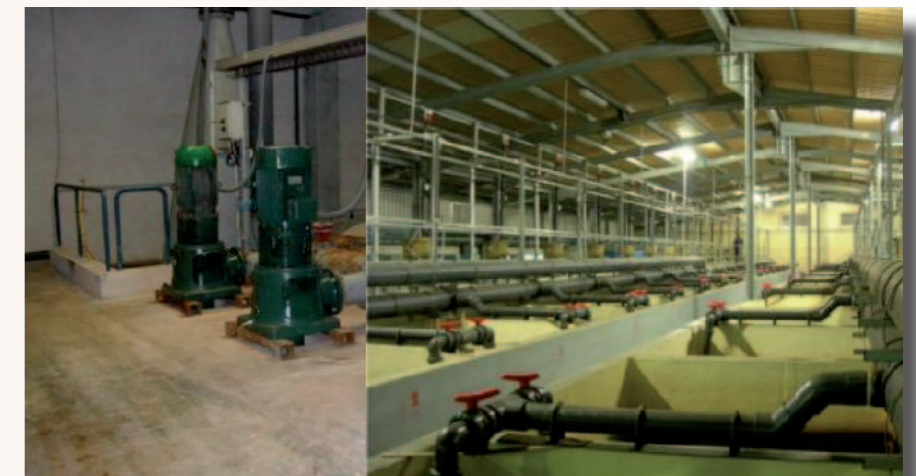
Fotografía 6: Bombas verticales de impulsión (izquierda) y nave de producción en la que se observan línea de tanques y tuberías (derecha)
