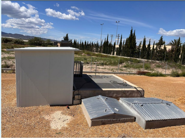
FOSO DE RECEPCIÓN ARQUETAS VALVULERÍA
