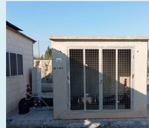
ARQUETA DE SALIDA CAUDALIMETRO DE CONTROL
