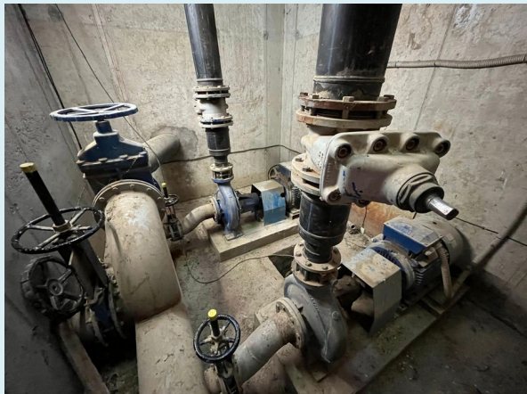
BOMBAS DE IMPULSIÓN
