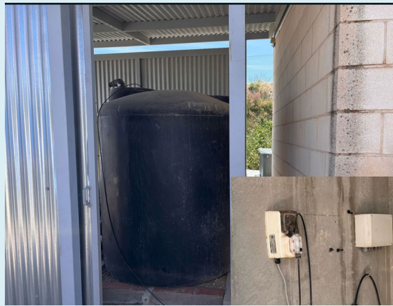
DEPOSITO HIPOCLORITO SODICO BOMBA DOSIFICADORA
