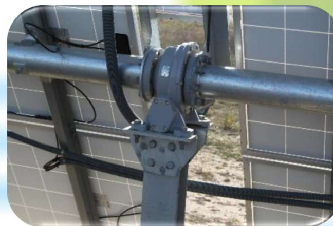
Estructura con seguidor Solar
