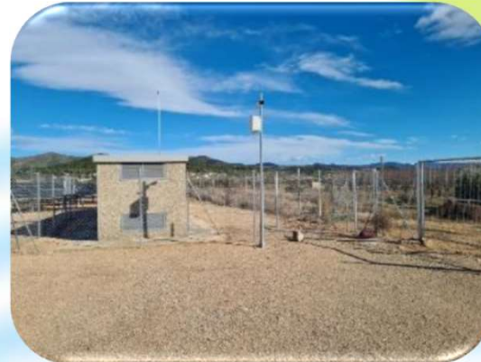
Casetas de CT y vallados
