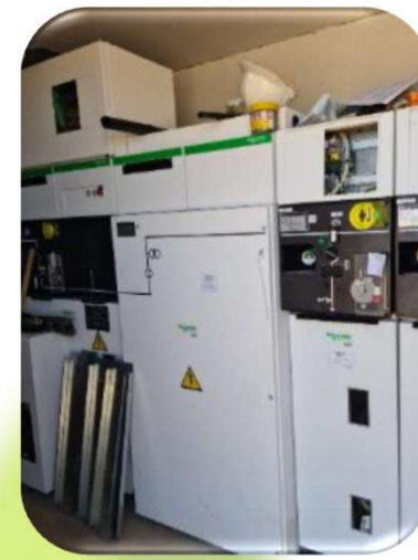
Cuadros, transformadores y celdas
