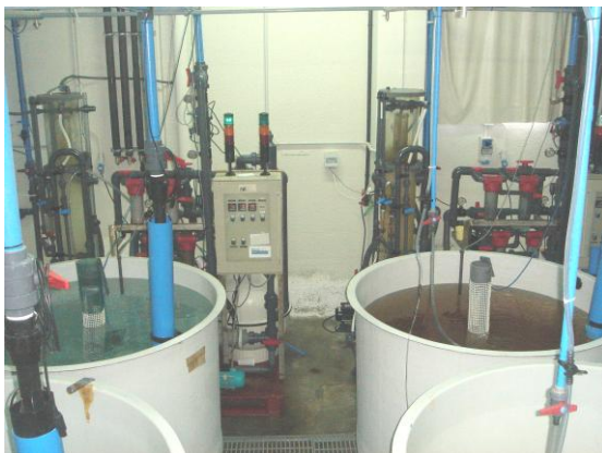
Módulo de tratamiento de agua, con ozonización (izquierda), y sin ozonización (derecha)
