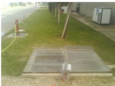
Arqueta de 2 m 3 donde viene toda el agua de la sala de patología
