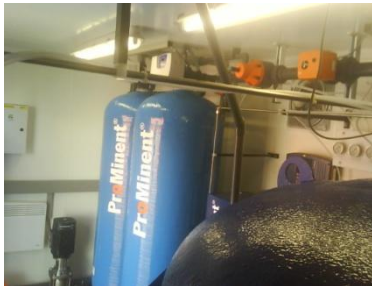
Vista del interior del módulo de tratamiento con ozono
