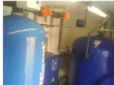
Vista del interior del módulo de tratamiento con ozono
