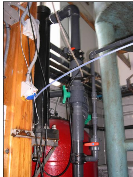
Foto 5: Sistema de esterilización del con ultravioleta.
