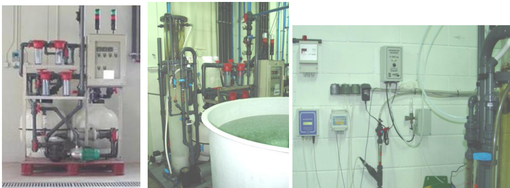
Módulo de recirculación de agua, detalle del fraccionador de proteína (skimmer) en el que se inyecta el ozono y detalle del generador de ozono
