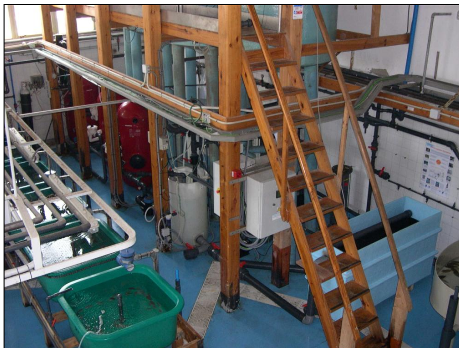
Foto 1: Visión general de las instalaciones del circuito cerrado.
