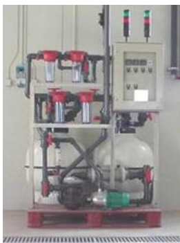
Módulo de tratamiento de agua
