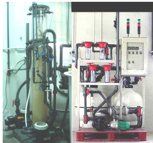
Módulo de tratamiento de agua con fraccionador de espuma
