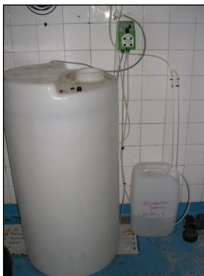
Foto 7: Tanque bicarbonato para regulación del pH.
