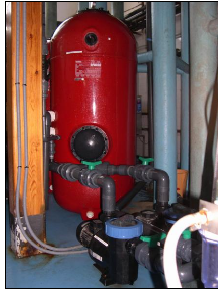
Foto 3: Filtración mecánica mediante filtro de arena.
