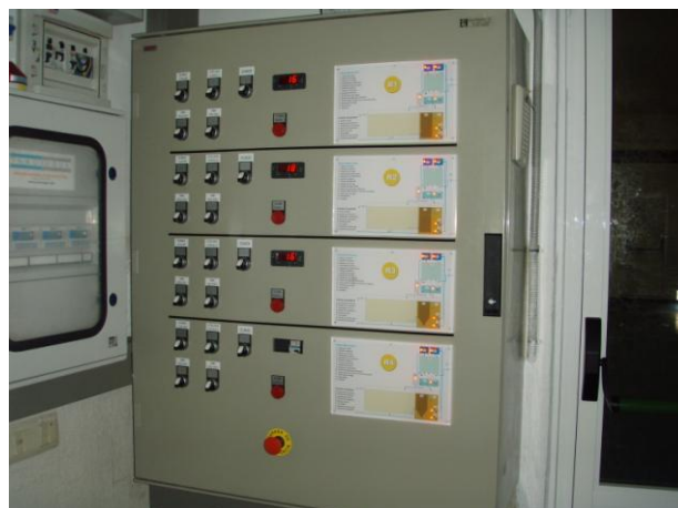
Foto 7: Cuadro de control y alarmas de los tanques de reproductores.
