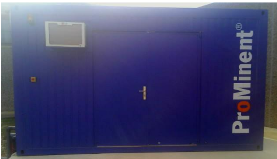
Modulo de tratamiento con ozono
