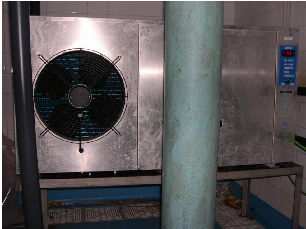
Foto 10: Bomba de calor.
