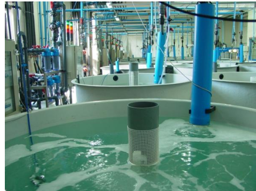
Detalle sala con Módulos IRTA
