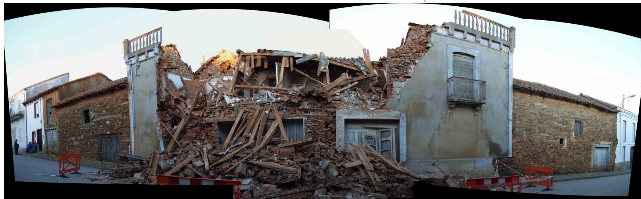
Situación actual de la casa elegida como ejemplo de aplicación en Destriana. Derrumbe Enero 2011. Montaje E. Prada
